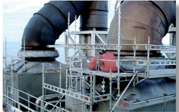
Tekstiilipaljetasain asennettuna savukaasukanavaan.
